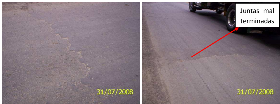
Foto 78. Juntas mal terminadas K23+235
