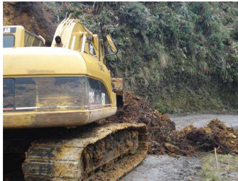
Foto 11. Material de desalojo en vía k29+500
