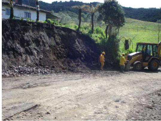
Foto 10. Desalojo de derrumbe K29+450 A K29+460
