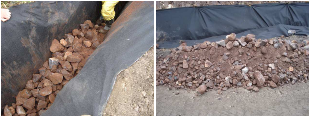
Foto 59. Material contaminado en la construcción de filtros
