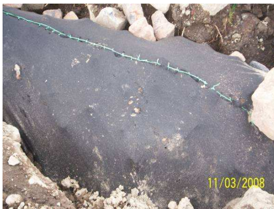
Foto 60. Geotextil en mal estado
