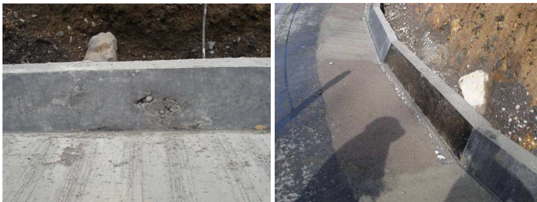
Foto 52. Hormigueos en las cunetas
