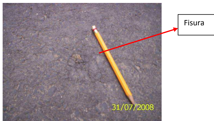
Foto 79. Fisura en carpeta asfáltica K23+194
