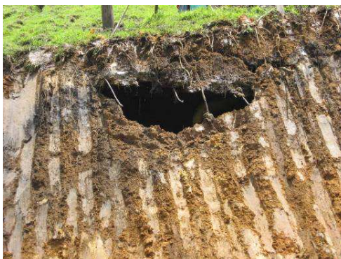
Foto 6. Pozo séptico K25+650
