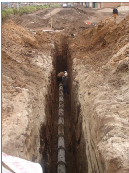
Figura 2. Excavación e instalación de tubería de cemento a una profundidad mayor a 3 m . Carrera 5 Norte.
