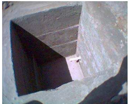
Cajilla en concreto para toma de muestras
