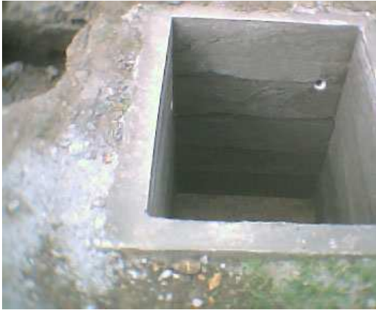
Caja en concreto para el filtro
