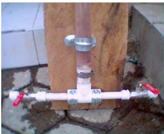
Llaves de cierre para salida (izq.), y lavado (der.)
