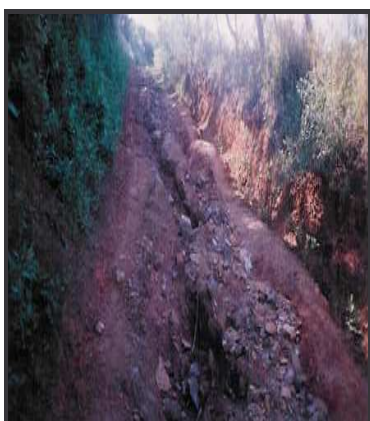
Carcavamientos profundos en la banca.
