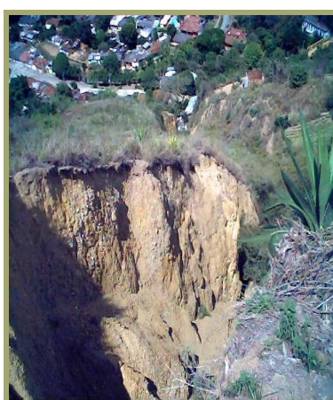
Cabeza de la cárcava, estado inicial.
