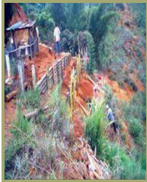
Estado inicial: Enero 2004
