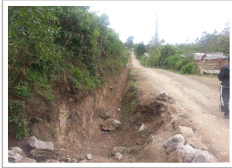
Fotografía N° 5.24 Vía circunvalar al Galeras PR 13+800 – Chapacúal bajo antes de intervención.
