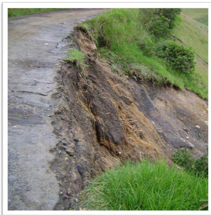
Fotografía N° 5.5 Pérdida parcial de banca en la vía Yacuanquer – El Rosario
