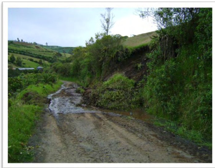
Fotografía N° 5.4 Destrucción de vía Yacuanquer – El Rosario San Felipe
