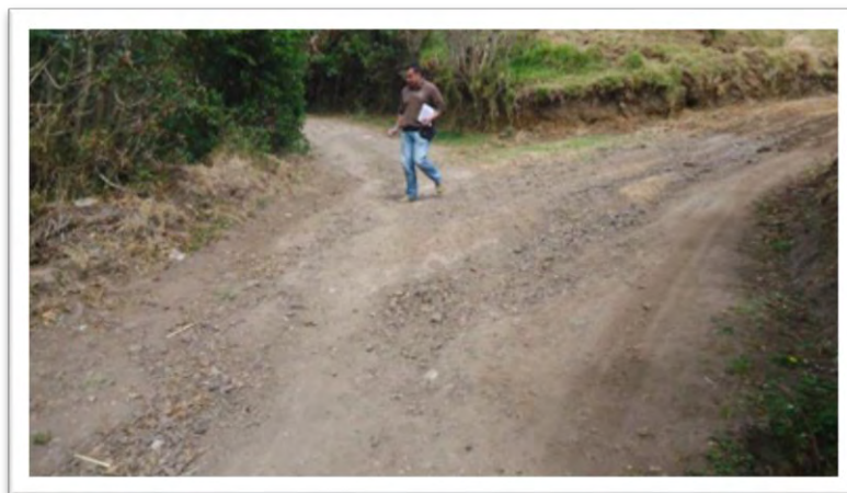
Fotografía N° 5.16 Vía El Rosario - San José De Córdoba antes de intervención.
