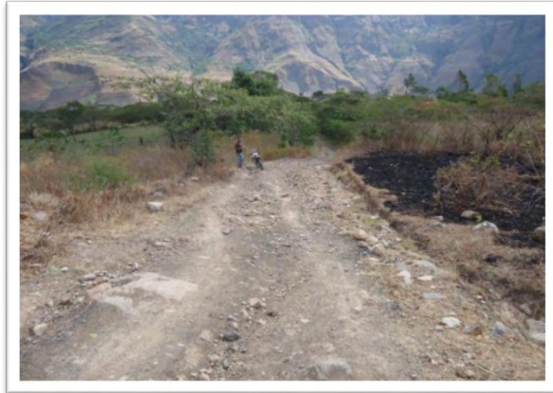
Fotografía N° 5.12 Vía Circunvalar Al Galeras K 18+940 – Zaragoza antes de intervención.
