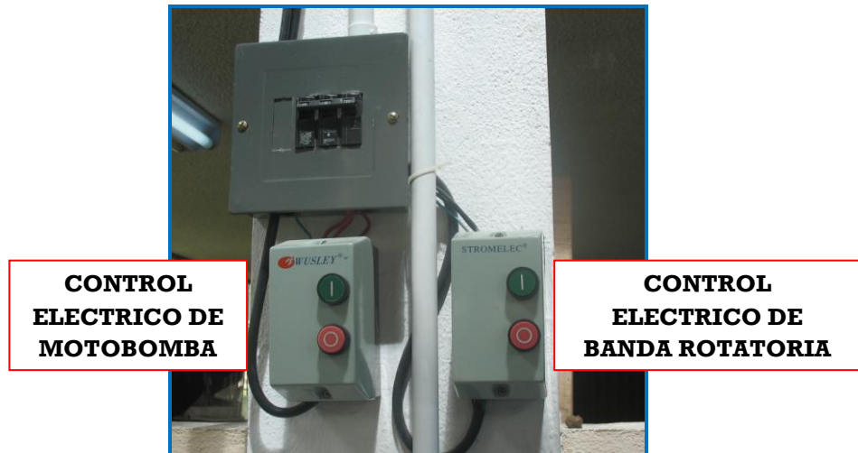
Fotografía 5.4. Tablero De Controles Eléctricos
