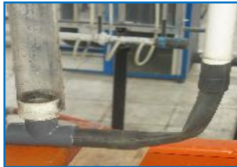
Fotografía 4.6. Codo Flexible En Caucho
