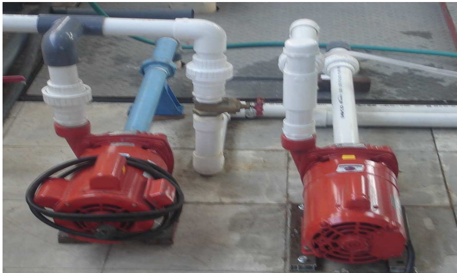
Foto 14. Sistema de abastecimiento con que cuenta el proyecto, la bomba 1 se encuentra a la derecha.
