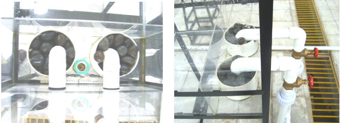
Foto 8. Vistas del sistema de pérdida de carga y aquietamiento, y del drenaje dentro del tanque de suministro.
