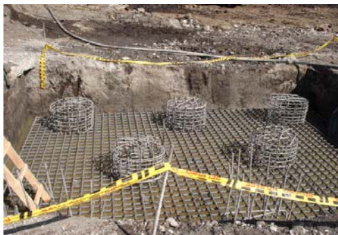
Figura 4. Doblamiento de refuerzo en reconstrucción de pilotes 6 flejes/7cm
