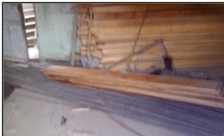
Figura 54. Almacenamiento de hierro bajo techo.
