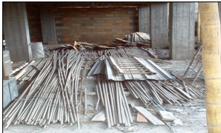
Figura 10. Almacenamiento de hierro bajo techo.
