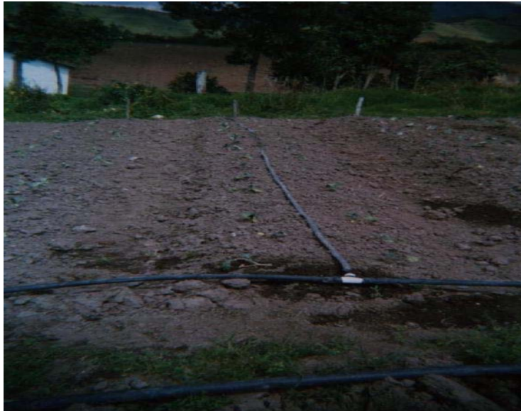
Figura 6. Instalación de la cinta exudante en el sistema de riego por Exudación
