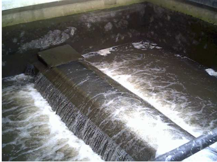
Figura 30. Filtro de Lavado por fuente Externa
