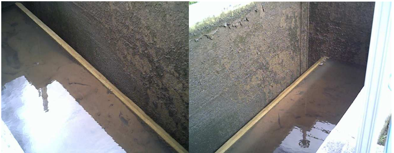
Figura 45. Ilustra el caso extremo de desacomodamiento del medio filtrante, inicialmente debido a una mala distribución del agua de lavado y falta de velocidad de ascensión.
