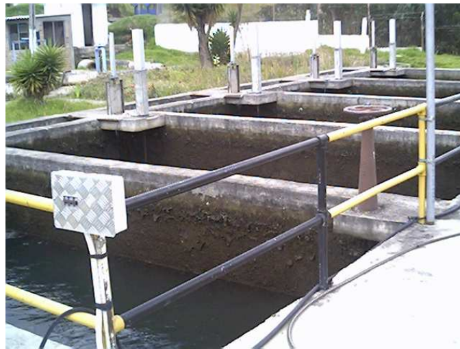
Figura 29. Vista General Sistema 2 Batería de Autolavado.
