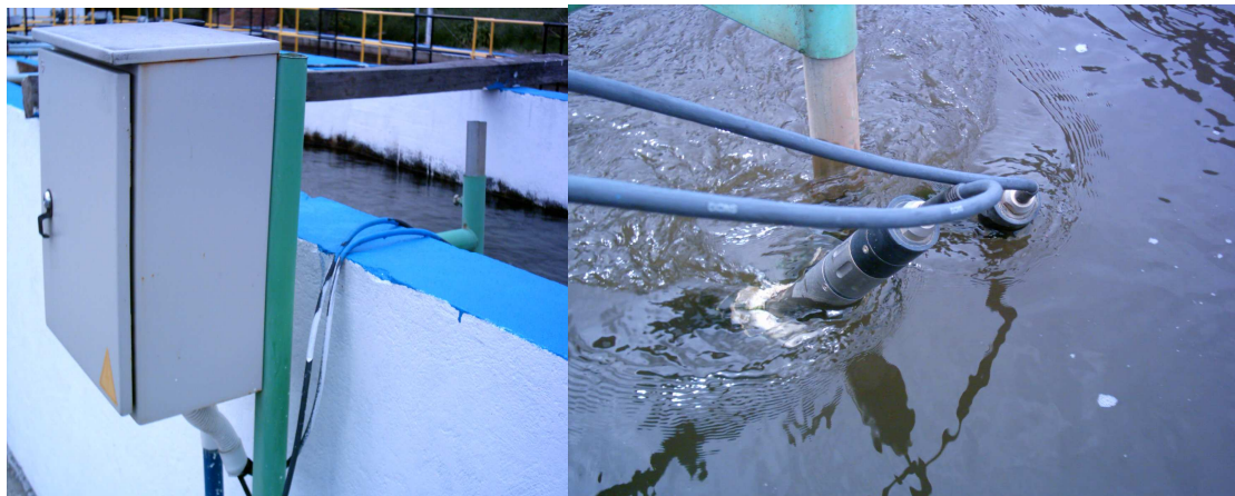
Figura 2. Sonda de turbiedad, pH y temperatura ubicada en canaleta parshall.
