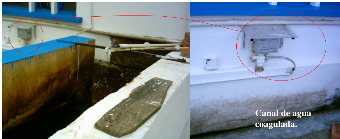
Figura 3. Punto de aplicación de coagulante y Ubicación de Streaming Current Monitor (sensor) en la línea de placas.
