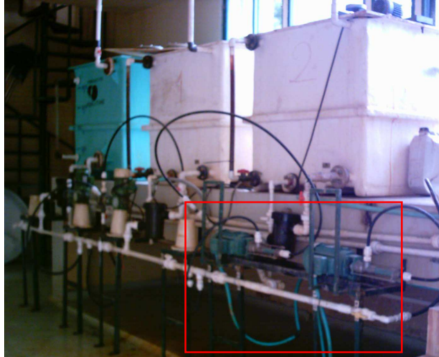
Figura 8. Disposición de bombas automatizadas para la dosificación de coagulante.
