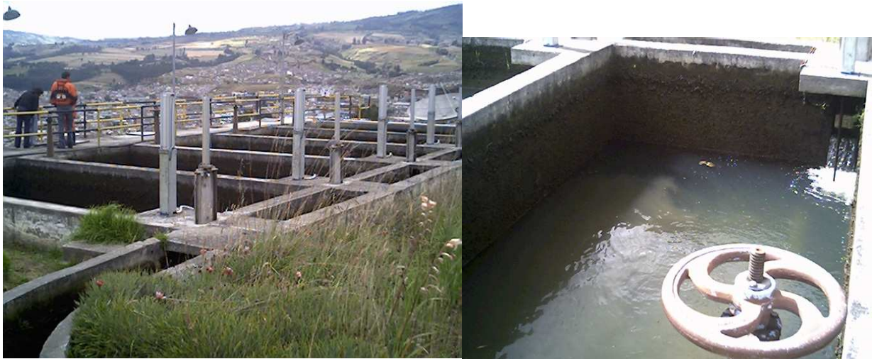
Figura 34. Canal de entrada de agua sedimentada a la batería de autolavado
