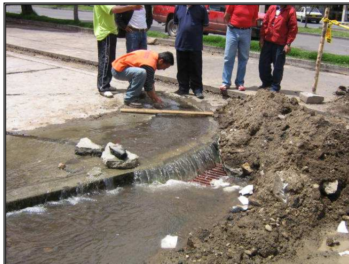
Figura 36. Rotura de tubería
