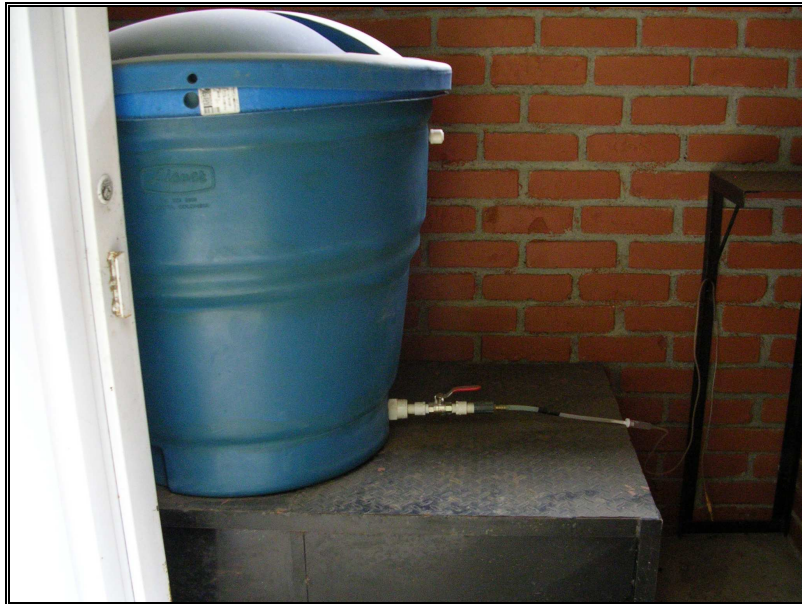
Figura 59. Sistema de desinfección
