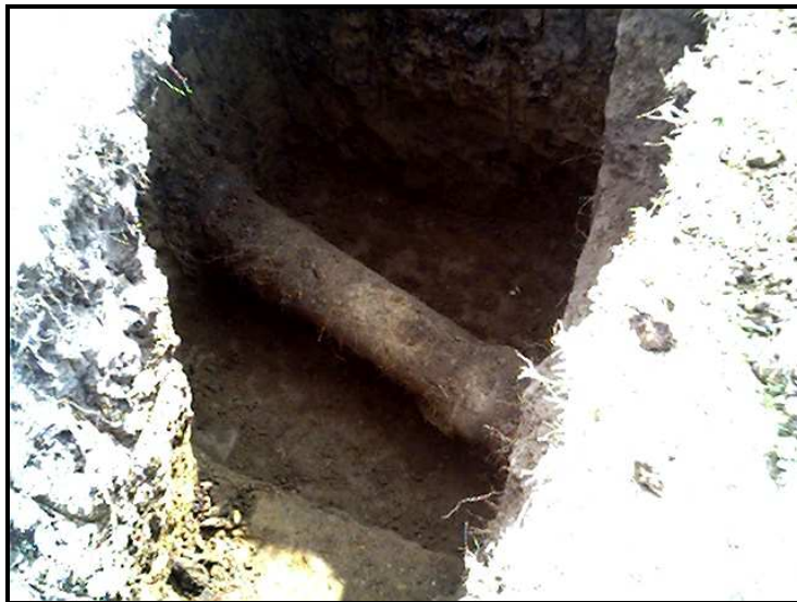
Figura 24. Tubería a reemplazar
