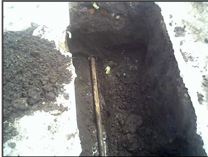
Figura 76. Barras de acero atravesando la tubería
