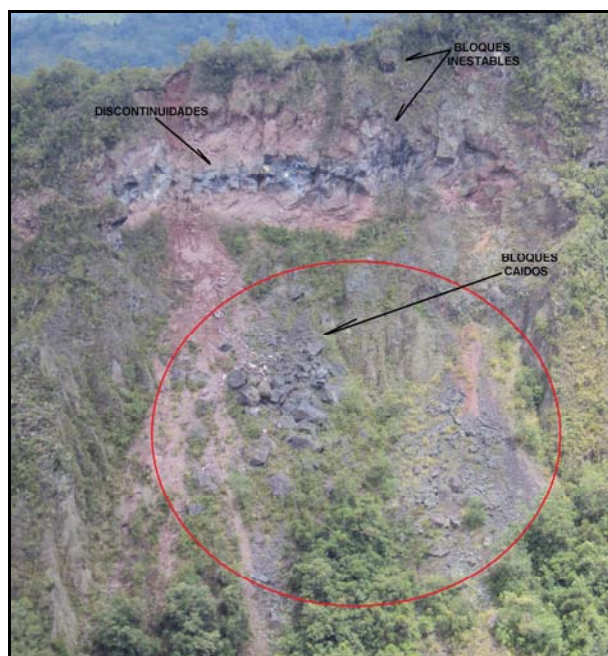
Figura 66. Superficie agrietada asociada a escarpes de rocas duras y fracturadas, vereda Valmaría
