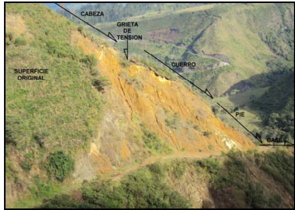
Figura 54. Perfil y partes del deslizamiento rotacional, vereda Gavilla alta
