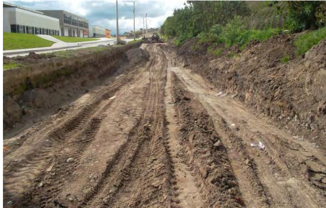
Figura No.25 Huellas de rodadas en la superficie de la Subrasante
