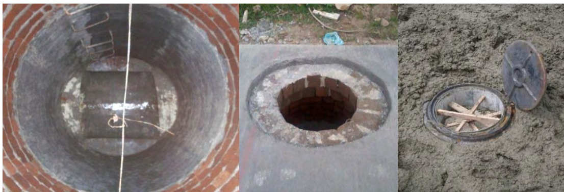
Figura No.21 Repello y tapas de Cámaras de inspección.
