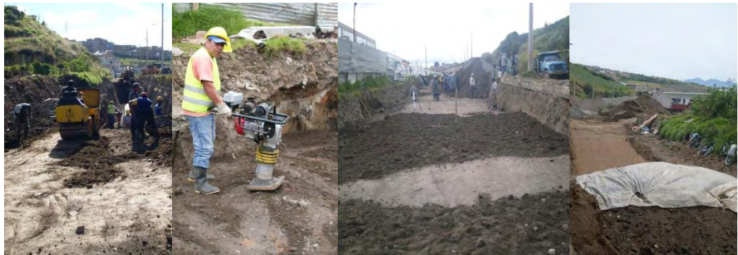
Figura No.23 Compactación, nivel final y protección de relleno reemplazo de Subrasante.
