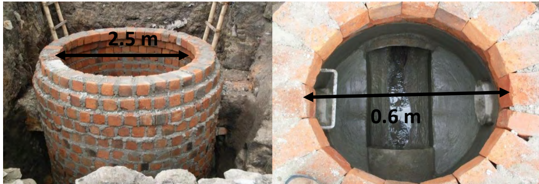
Figura No.20 Cámaras de inspección.
