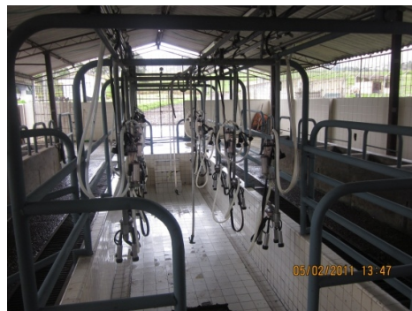
Figura 31. Sala de ordeño de finca LOPE con sustitución de mangueras y potencia adecuada que permite un óptimo fluido de agua.
