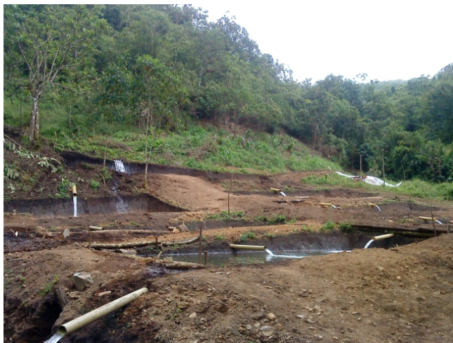
Figura 14. Estado inicial de los estanques.
