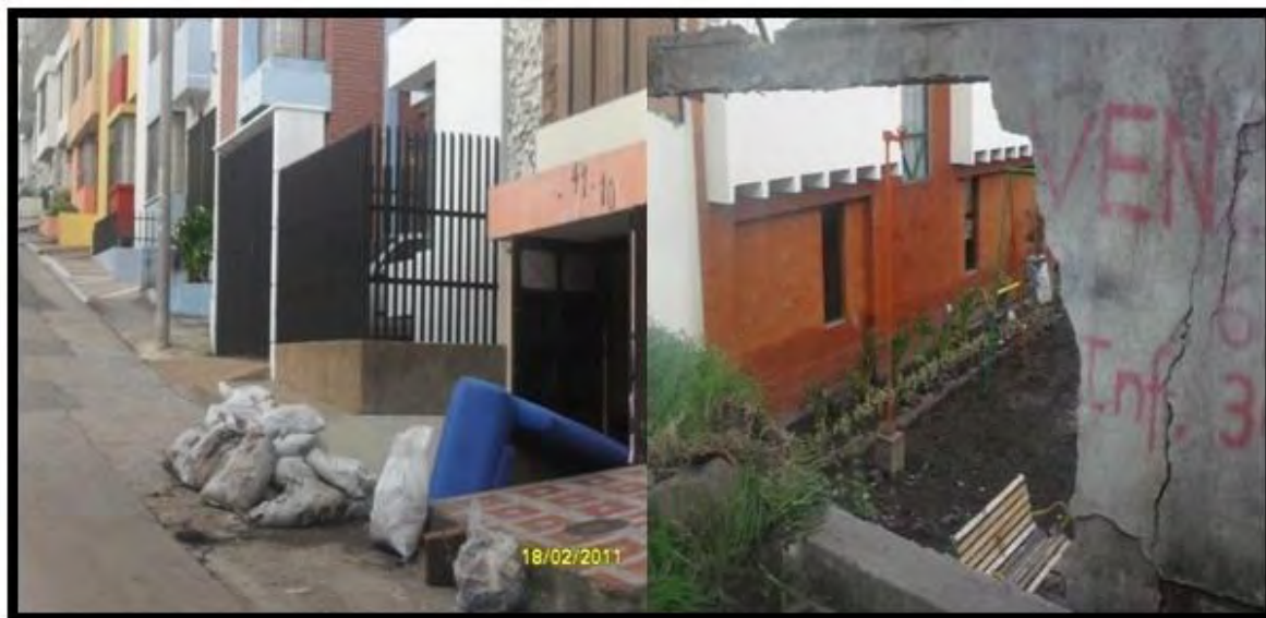
Figura 22. Daños causados por inundación parte baja barrio Mary Luz, año 2011.
