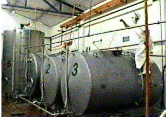
Tanques de Almacenamiento
