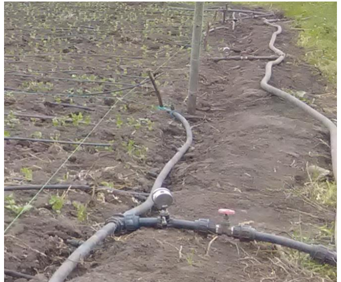
Figura 13. Control módulo de riego.
