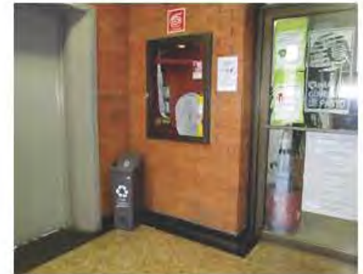
Gabinete de incendios
