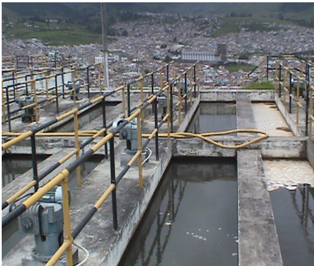
Figura 1. Planta de tratamiento Centenario
