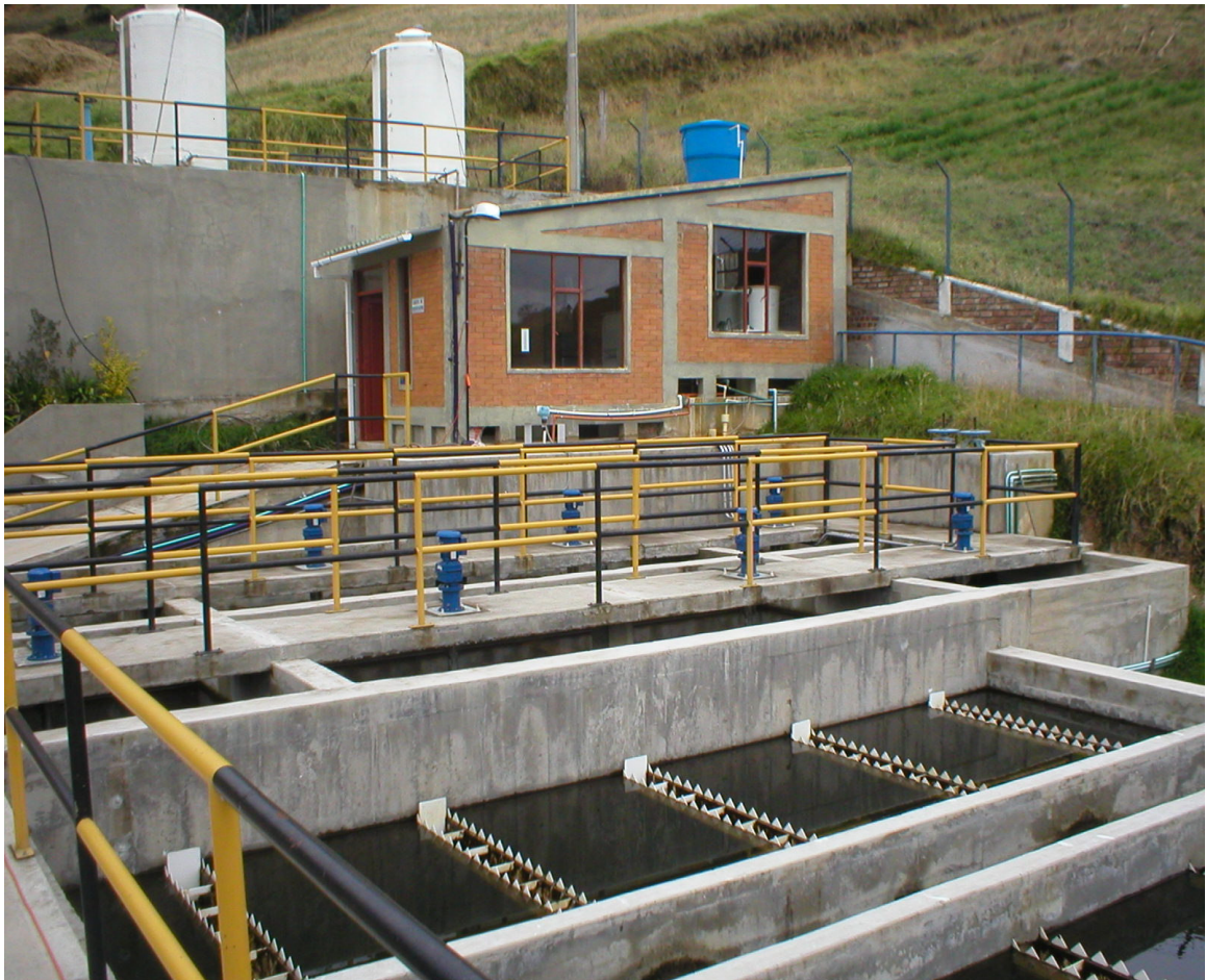
Figura 3. Planta de tratamiento San Felipe
