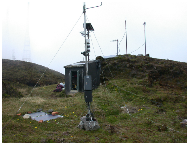
Figura 17. La estación “cráter” de la red de monitoreo del INGEOMINAS. En la parte frontal de la foto, se aprecia el mástil ecualizable que contiene los componentes de la estación climatológica.
