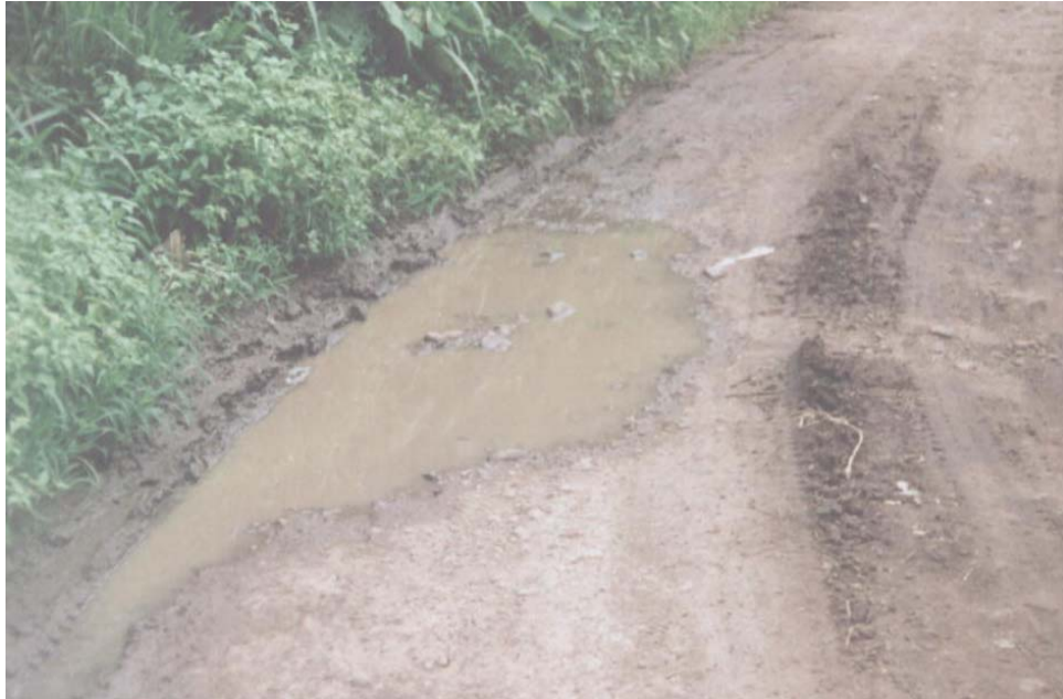
Figura 43. Estado Actual de la Vía
