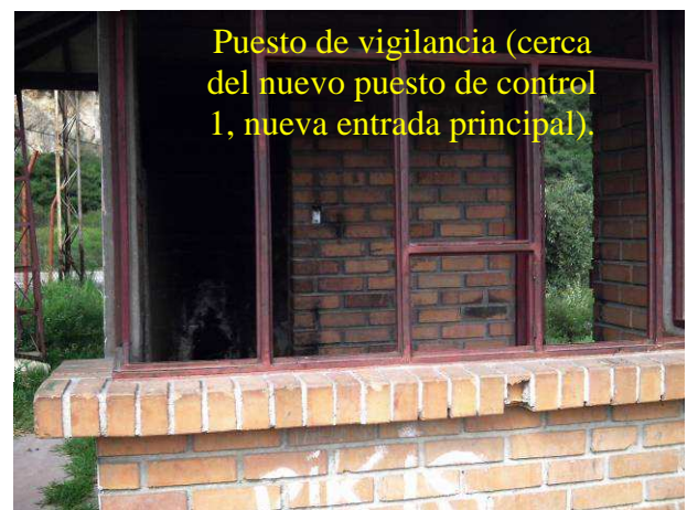
Foto 3 y 4. Estado de deterioro en que se encontraba el parque.
