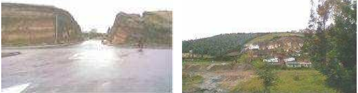
Foto 49 y 50. Taludes Vía Perimetral Sur Barrio El Charco y extracción de material del subsuelo.
