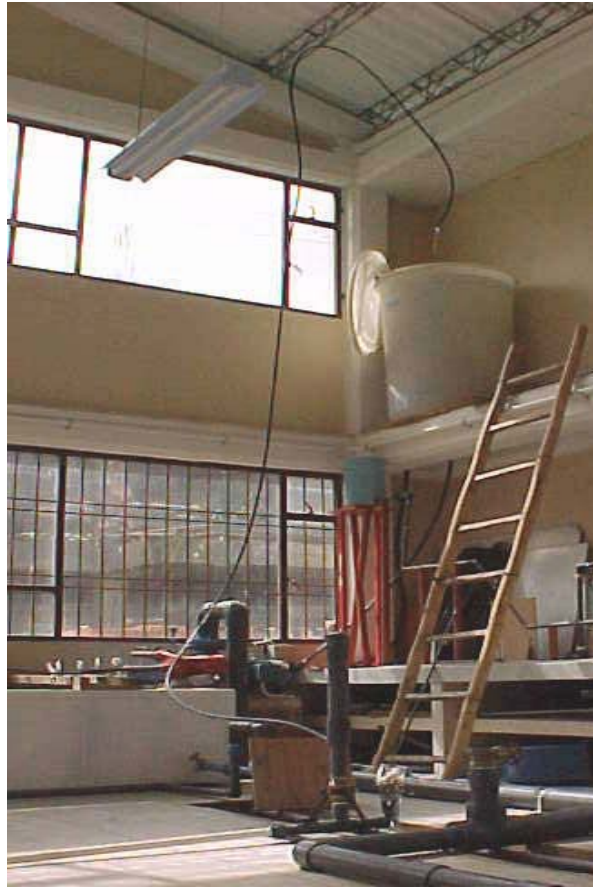
Figura 29. Manguera de Salida Ariete – Tanque de Almacenamiento
