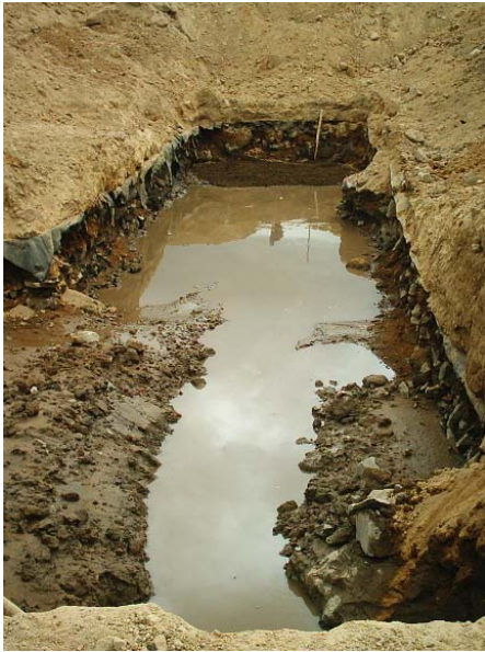
Figura 39. Presencia de nivel freático superficial
