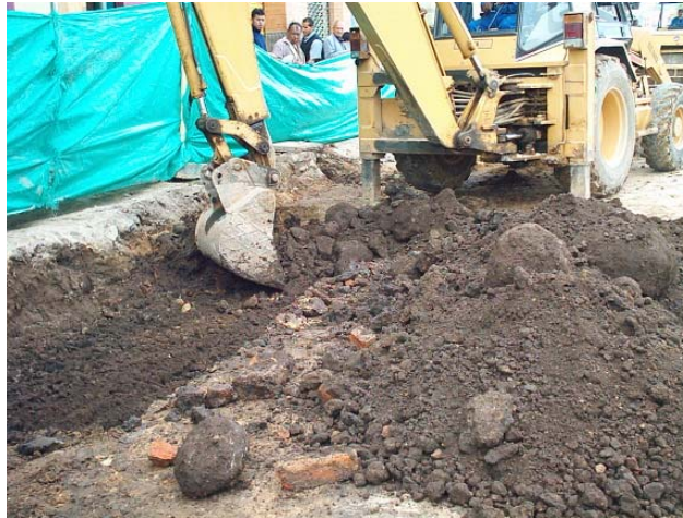
Figura 23. Material de mala calidad
