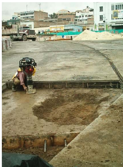
Figura 49. Problema de Acolchonamiento
