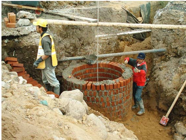
Figura 111. Cámara de inspección
