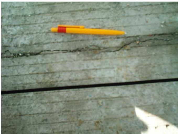
Figura 89. Fisura por Retracción y fraguado
