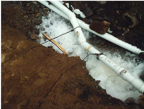
Figura 106. Localización Tubería hidráulica
