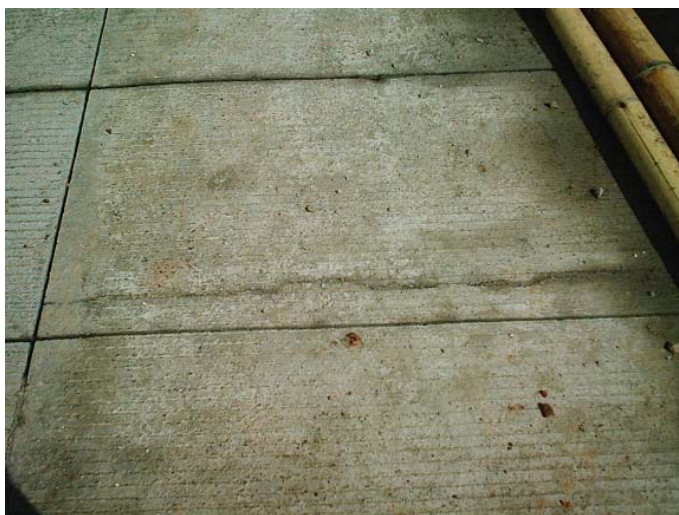
Figura 90. Fisura en calle 18
