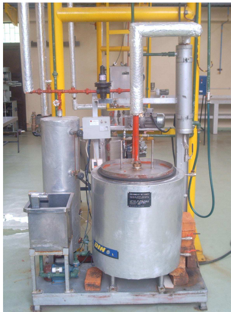
Figura 6. Unidad de Extracción de arrastre con vapor 2
