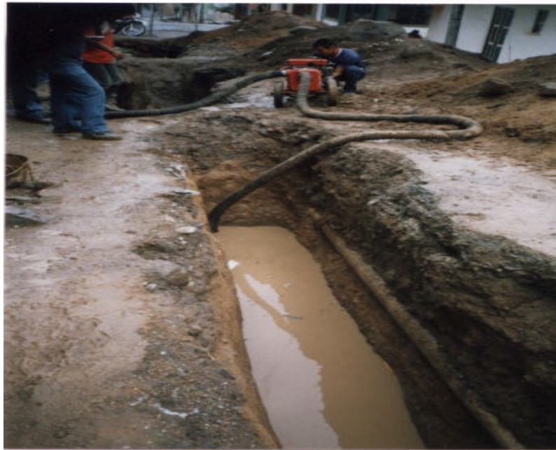
Figura 9. Evacuación de agua
