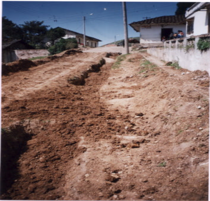
Figura 19. Relleno sin compactación Parte II
