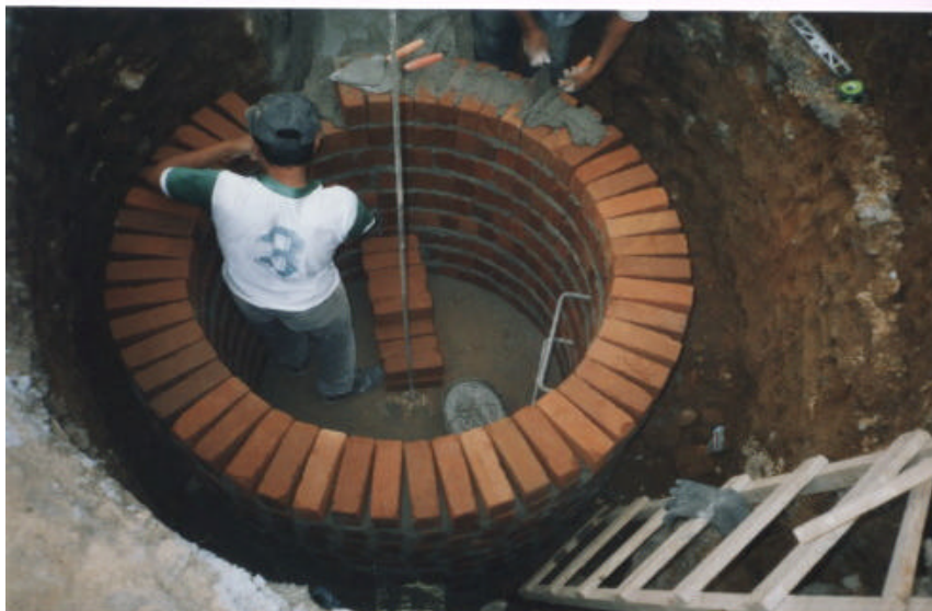
Figura 22. Cámara de inspección
