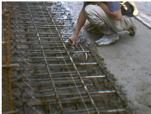
Figura 52. Junta constructiva en la placa de piso (no proyectada)
