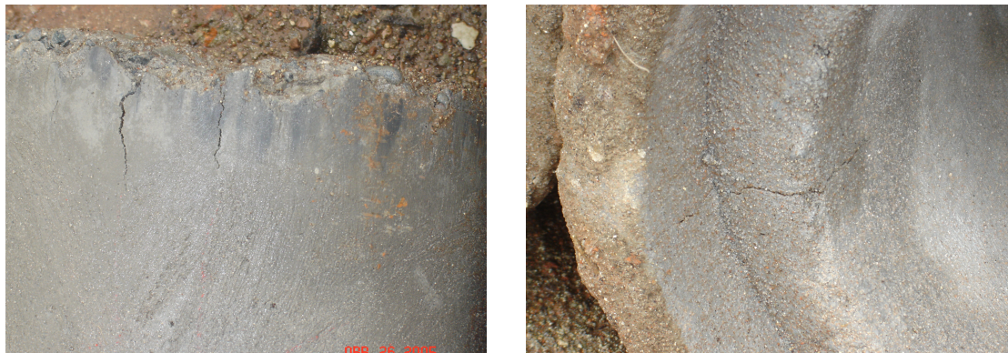
Figura 111. Tubería de concreto defectuosa
