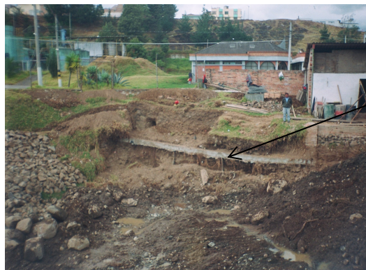
Figura 95. Tubería PVC 4” existente encontrada en el sector de excavación
