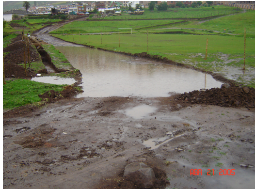
Figura 117. Inundación en la zona baja de la vía
