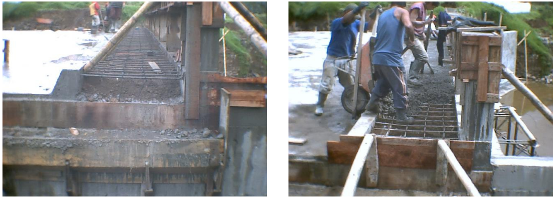
Figura 69. Acero de refuerzo, relleno (e = 0,15 m) y fundición de placa para andenes.
