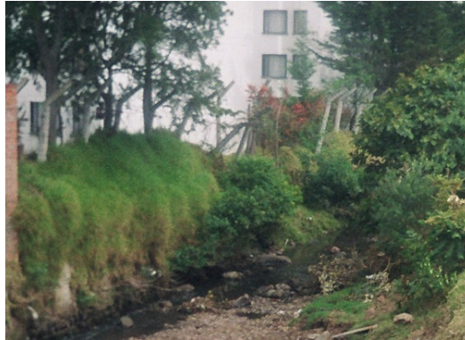
Figura 92. Talud sin protección - sector Pucalpa II
