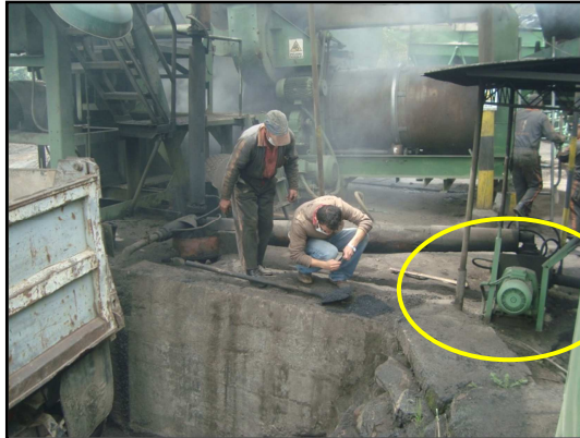
Figura 14. Sistema dosificador de cemento asfáltico
