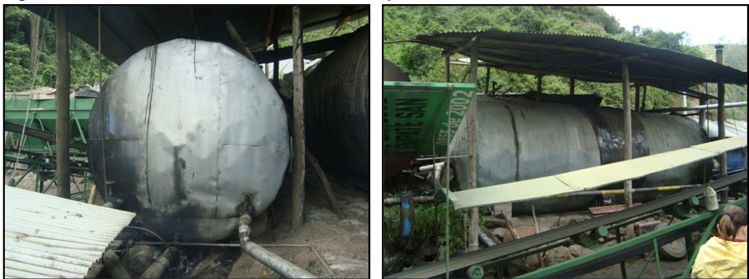
Figura 13. Sistema de almacenamiento y calentamiento del cemento asfáltico
