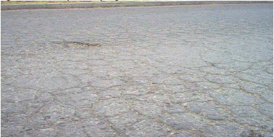
Figura 17. Falla de un pavimento por agrietamiento.
