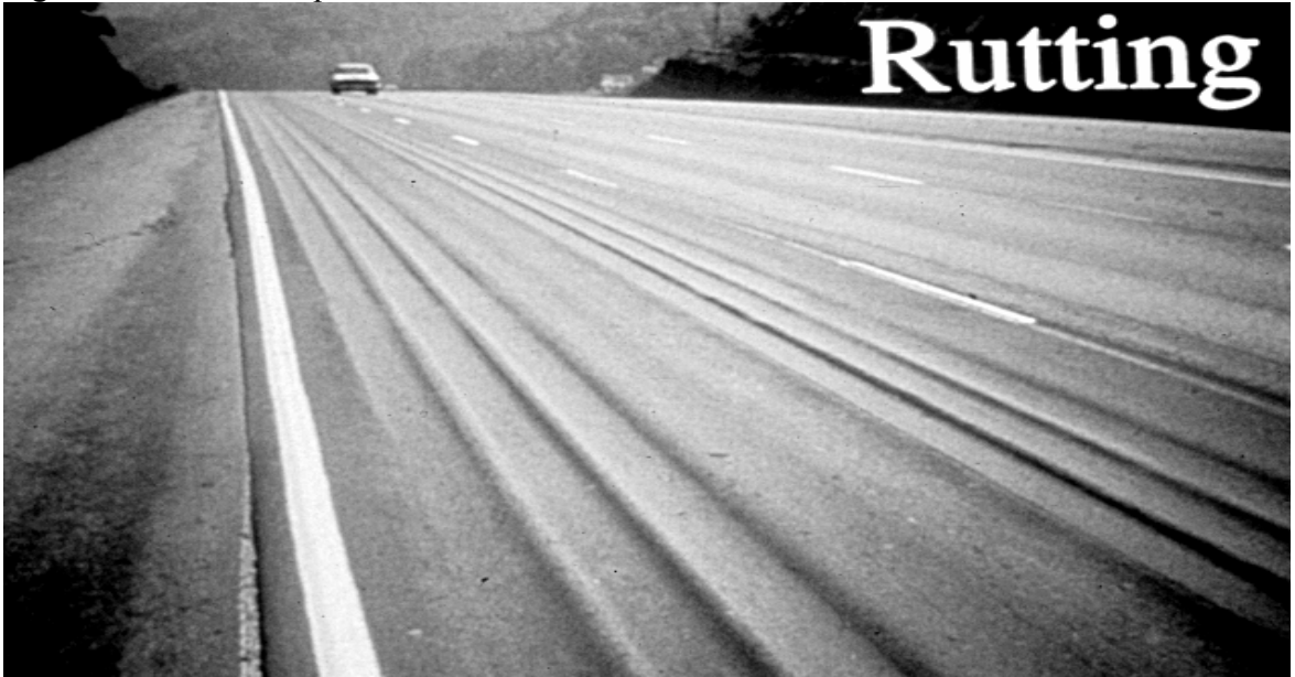
Figura 16. Falla de un pavimento debido al ahuellamiento.
