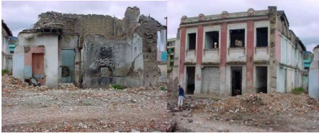
Figura 6. Estado de los inmuebles 0185-011-012-027-029-030
