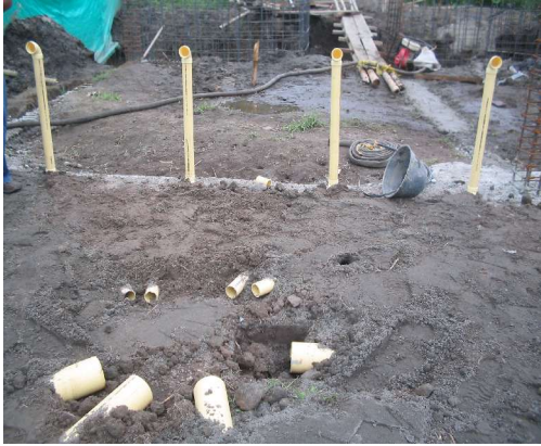
Figura 38. Tubería sanitaria e hidráulica
