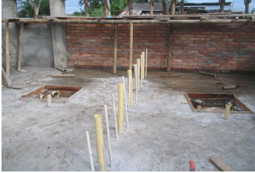
Figura 53. Red hidráulica (tubería blanca)
