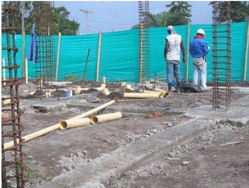
Figura 40. Identificación de las tuberías
