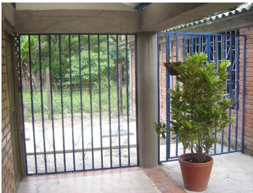
Figura 73. Puertas en hierro, separa la estructura del sistema de tratamiento
