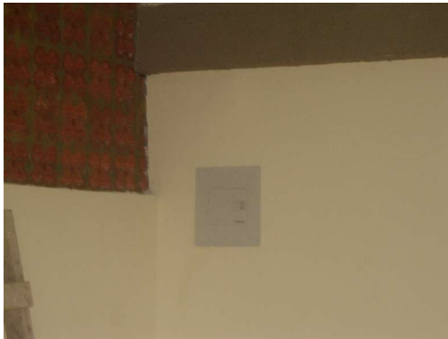
Fig. 59 Tablero de circuitos
