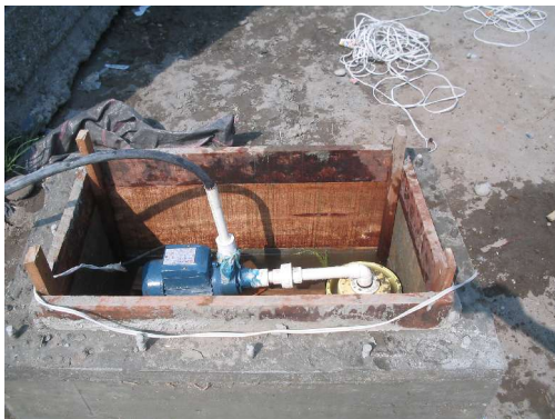
Figura 58. Suministro de agua de tanque profundo.
