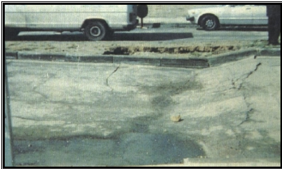
Figura 1. Defectos provocados por una ejecución inadecuada de los rellenos de las zanjas: hundimiento de calzada y acera
