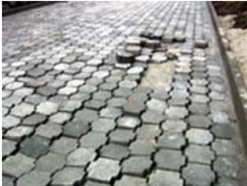
Figura 38. Daño entre abscisas K0+00 A K0+30
