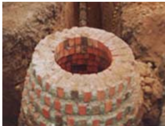
Figura 7. Cámara de inspección
