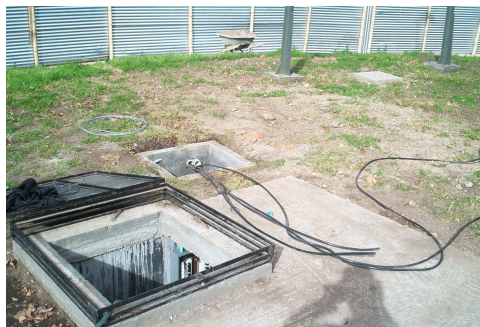
Figura 97. Acometida a tablero en baja tensión.
