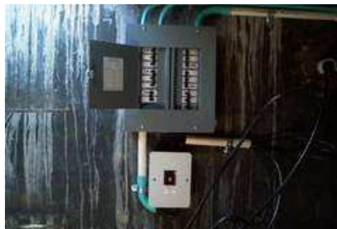
Figura 117. Instalacion totalizador de 60A.
