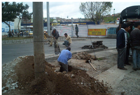
Figura 108. Rotura de pavimento
