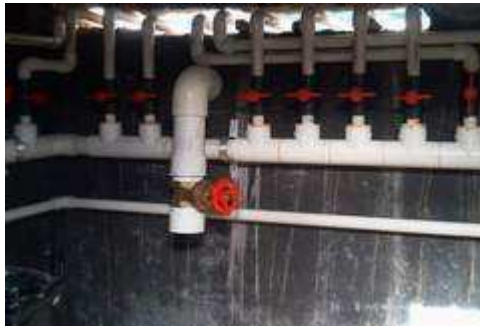
Figura 67. Válvula de 2" para filtro
