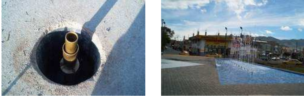
Figura 102. Instalación chorros aireadores.
