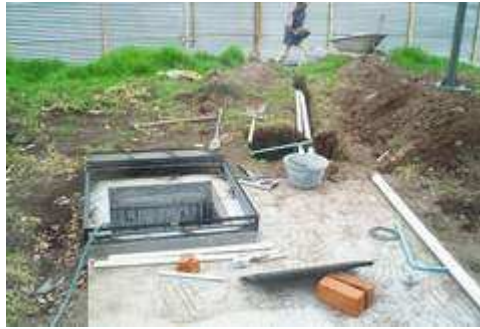
Figura 70. Tapa metálica para acceso al cuarto de máquinas.
