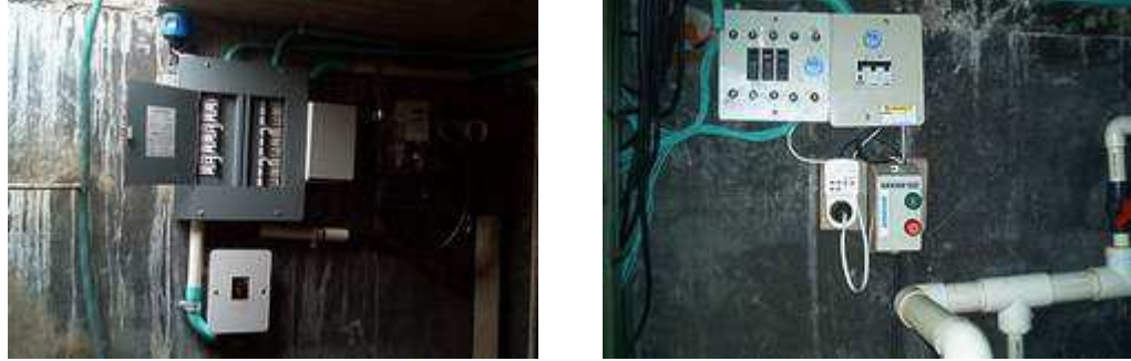
Figura 118. Cajas de distribución.
