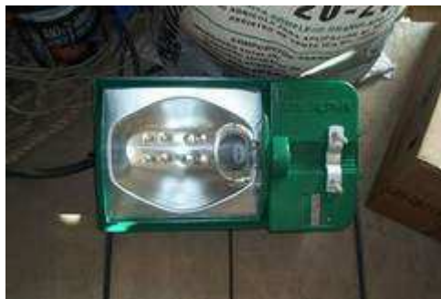
Figura 59. Luminaria de 70 w Na con fotocelda.
