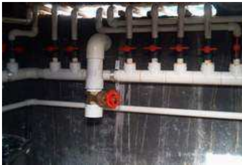
Figura 103. Instalación múltiple de 10" salida con válvula de bola de 1".
