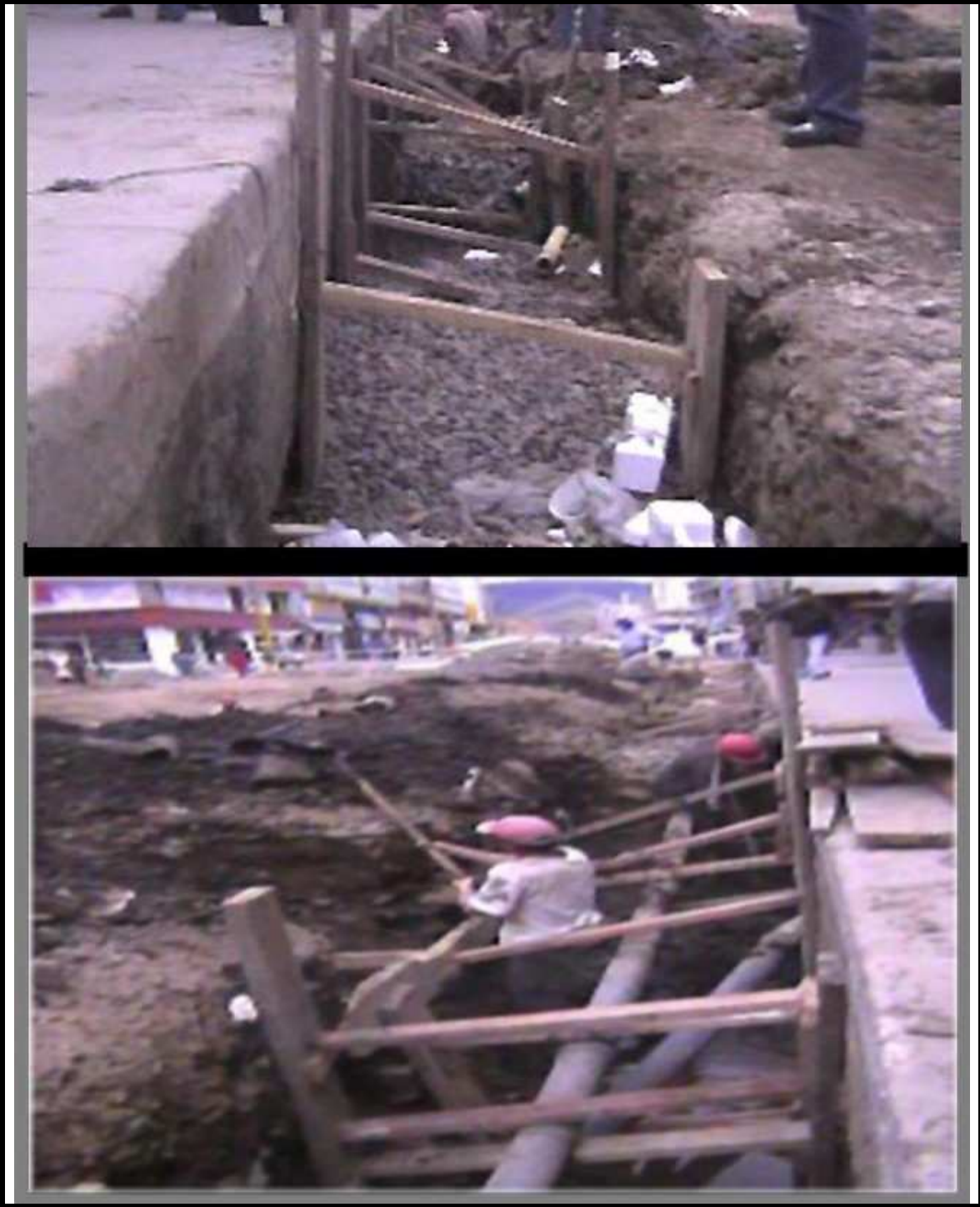
Figura 22. Capa de triturado en zona de falla
