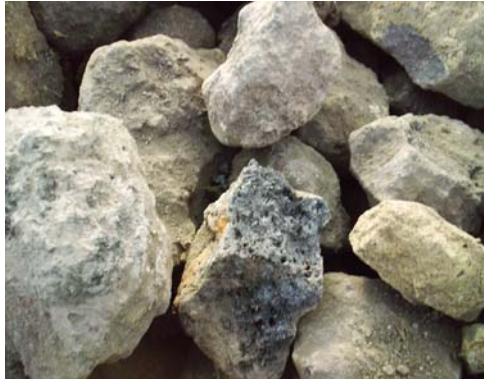
Figura 41. Material de sub-base que necesita ser mejorado.
