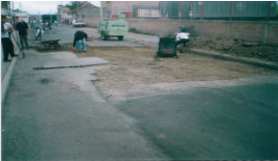
Figura 70. Demarcación y cajeo de la falla. Barrio Centenario.
