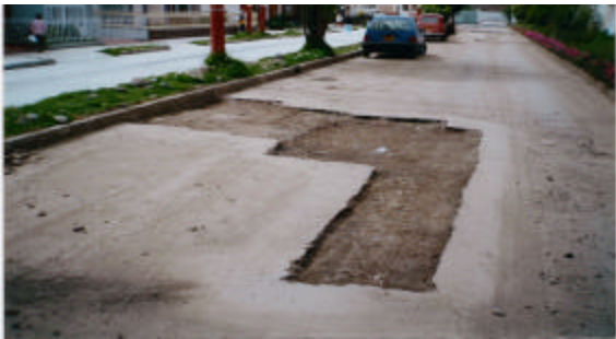
Figura 68. Demolición y retiro de la carpeta asfáltica deteriorada. Calle 24 entre carreras 8 y 9 calzada oriental Urbanización La Castellana.
