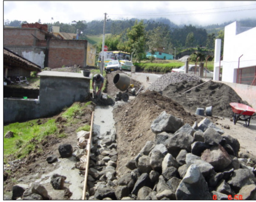
CONSTRUCCION DE MURO EN CONCRETO CICLOPEO TERMINACION CUNETAS Y MUROS DE CONTENCIÓN –GENOY
