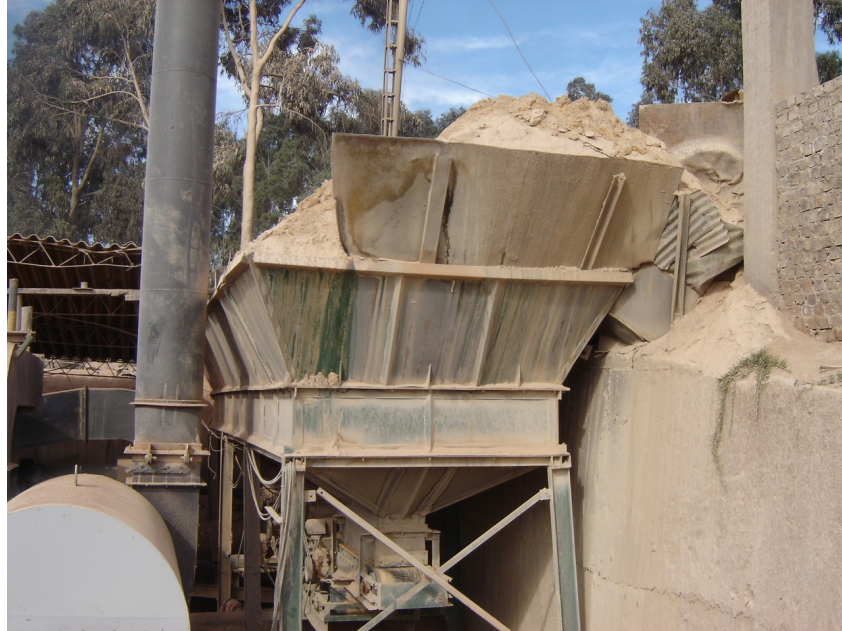
Figura 28. Tolvas en frío
