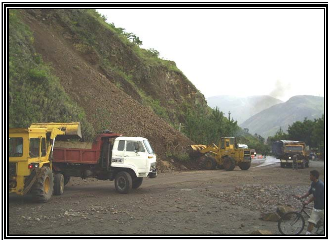
Figura 23 Despeje de derrumbe Marzo 21 de 2005
