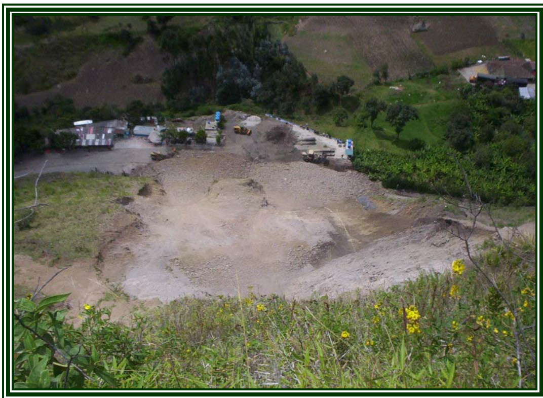
Figura 1. Vista superior del talud en El Borojó PR 33+ 0350 tramo 2501
