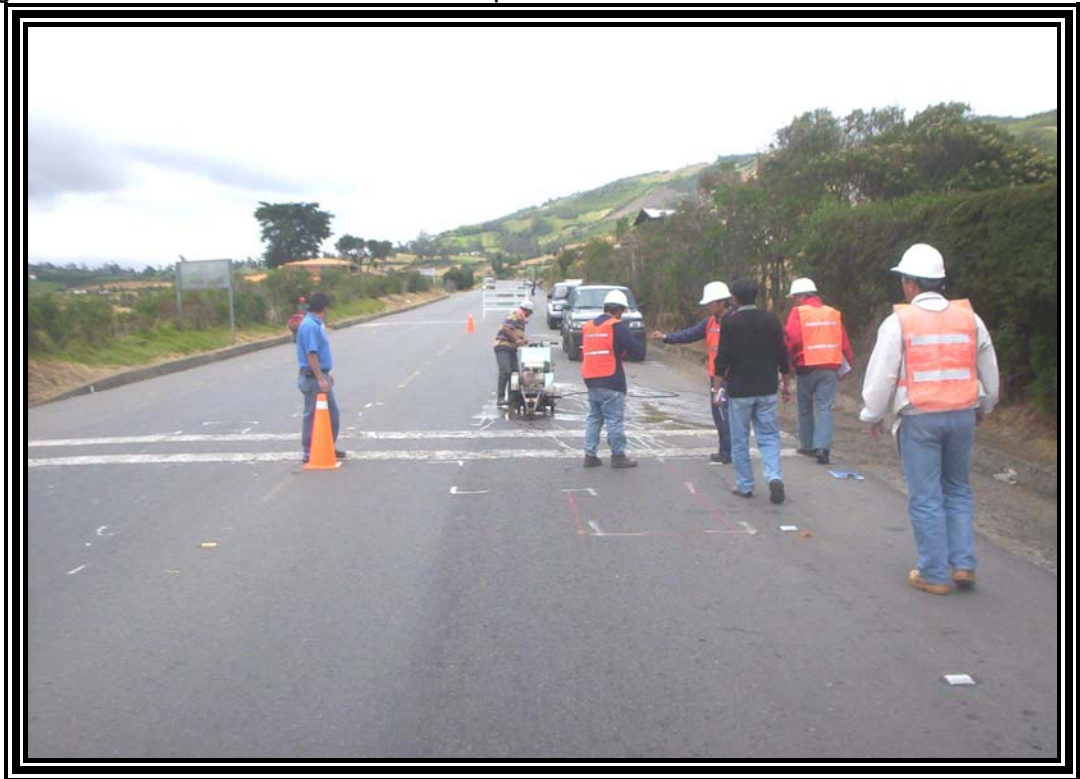
Figura38. Corte del area afectada del pavimento
