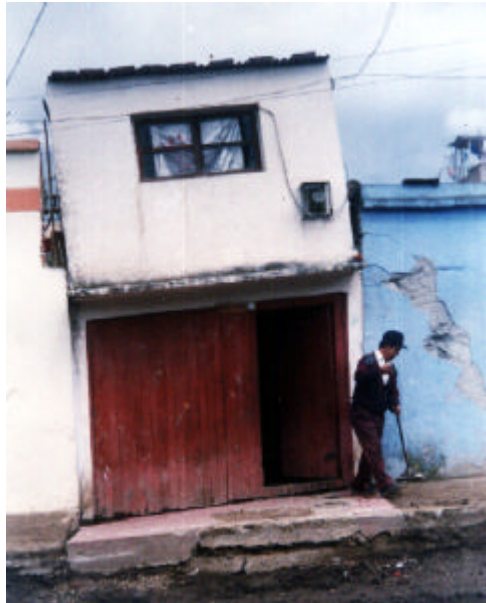
Figura 31. Vivienda afectada por asentamientos diferenciales
