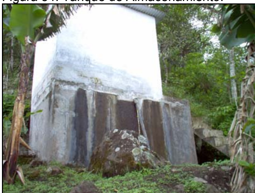
Figura 34. Tanque de Almacenamiento.
