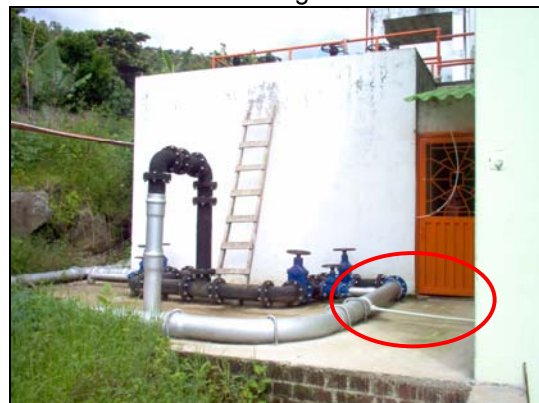
Tubería de conducción agua tratada
