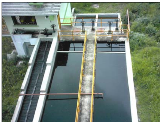
Figura 23. Vista aérea PTAP.
