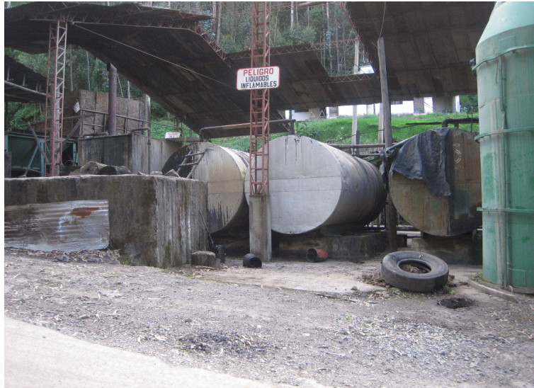
Figura 18. Tanques de Asfalto
