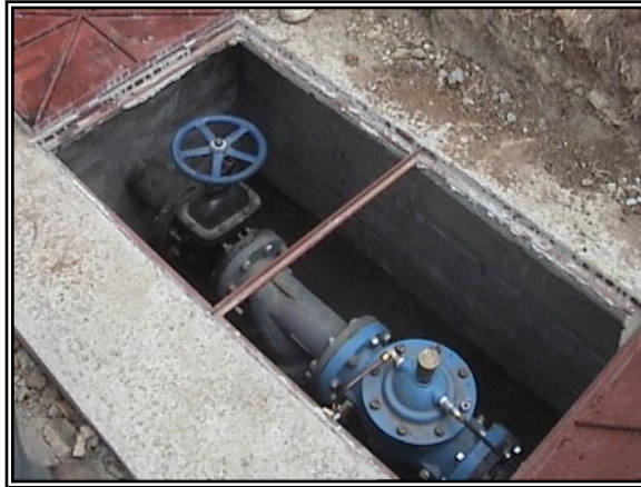
FOTO No. 11 DETALLE CAJILLA PARA VÁLVULA DE CIERRE LENTO Y CAMARA DE QUIEBRE.
