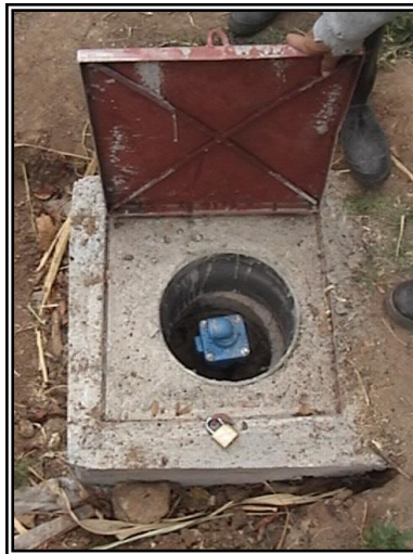
FOTO No. 12 DETALLE CAJILLA VÁLVULA DE PURGA
