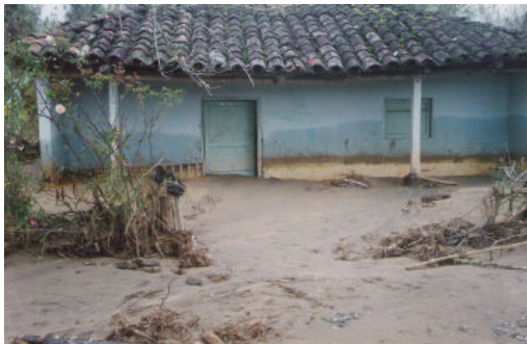
Viviendas afectadas por la inundación del 20 de mayo de 2000 Sector Las Cochas.
