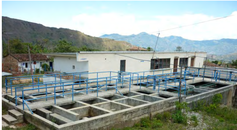
Imagen 60. Planta de tratamiento casco urbano Buesaco
