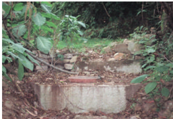
Figura 10. Captación Tipo Lecho filtrante , Quebrada Ojo de Agua, Centro Poblado de Aranda
