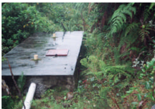
Figura 3. Desarenador convencional Quebrada La Pila, Cabecera del Corregimiento de Cabrera
