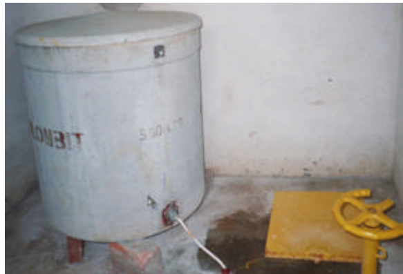
Figura 16. Tanque de almacenamiento de cloro, Centro Poblado de Aranda
