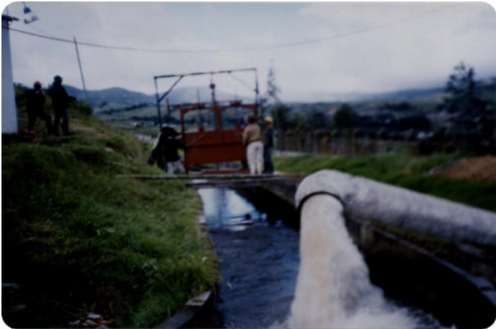
Figura 22. Transporte compuerta de guillotina doble vastago
