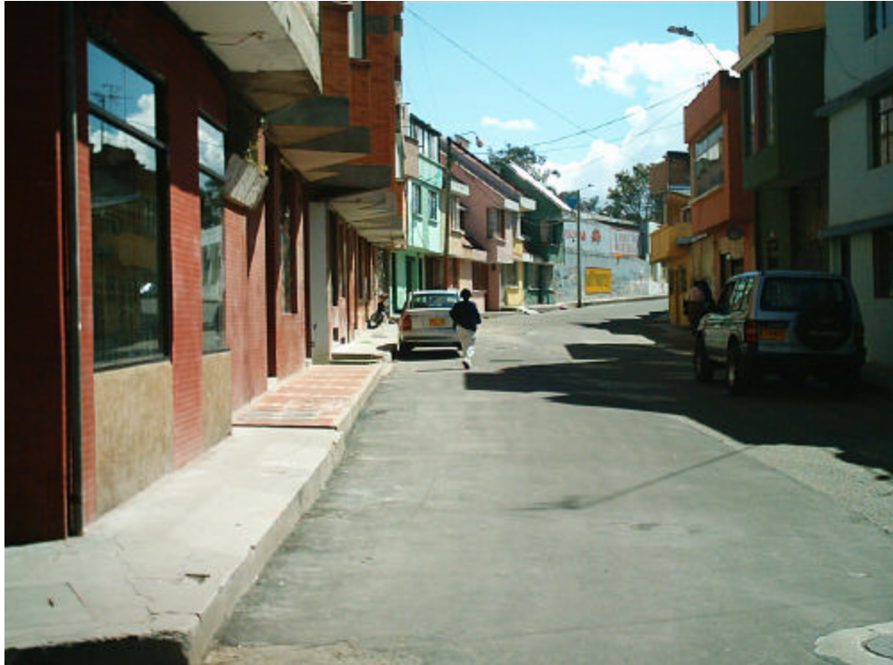
Figura 30. Terminación de la obra en su totalidad. Alcantarillado Carrera 31C, calles 18 y 19.
